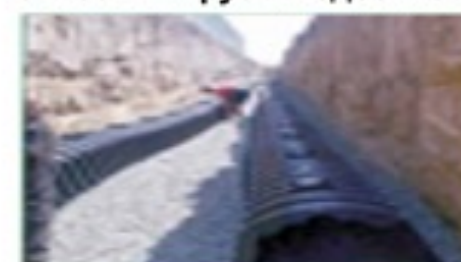
Инфильтрационные тоннели и блоки для отвода вод
